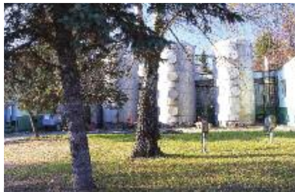
Vas- és mangántalanító állószűrők (jelenleg)
