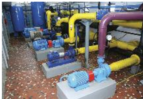
Szivattyú gépterem, az új szivattyúkkal
